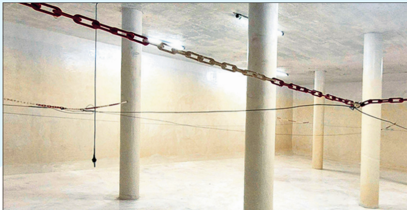
Das Budget 2026 sieht die Instandstellung der Beschichtung in der Reservoirkammer Mürgen (Bild) vor.
