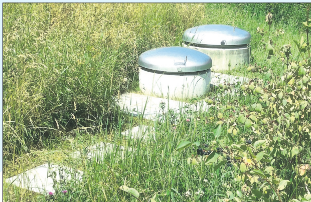
Grundwasser-Filterbrunnen der Wasserversorgung Werthenstein.
