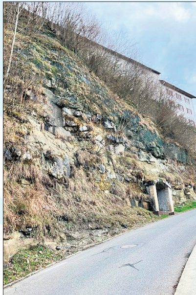
Die Felswand oberhalb des Klosterstutzes muss nach einem Steinschlag gereinigt werden.
